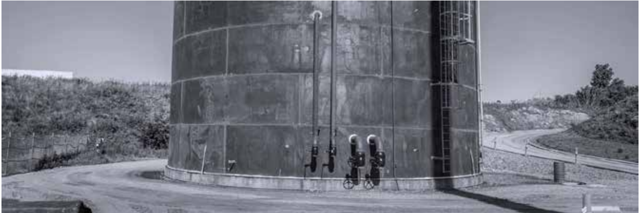
Ciepłownia Hobro - nowa ciepłownia z zaworami BROEN BALLOMAX.
